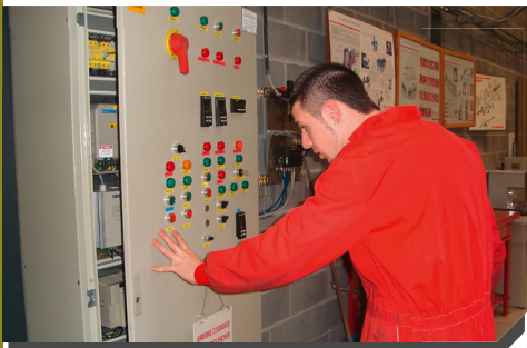
Armoire de commande industrielle
