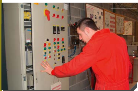
Armoire de commande industrielle
