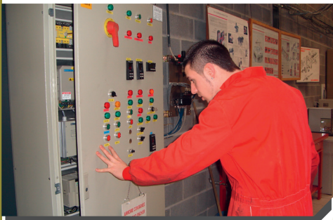
Armoire de commande industrielle
