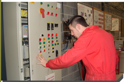
Armoire de commande industrielle
